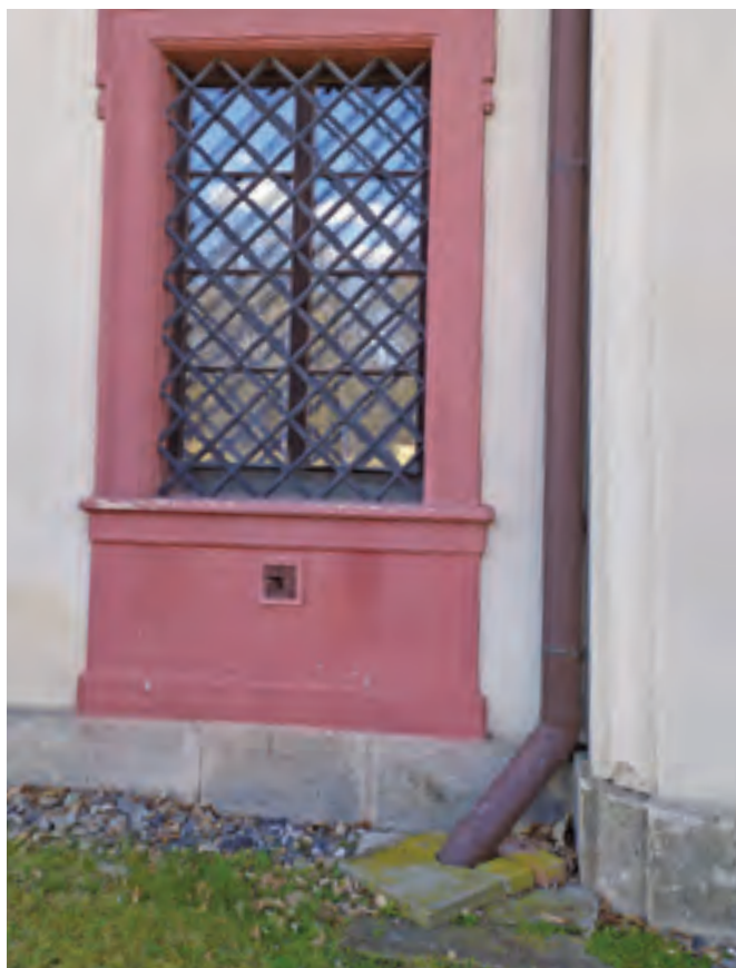
7 Zaústění dešťového svodu do kanalizační větve H po zrušení kamenných kanálků. Zdroj: foto Jana Melcrová (2019).
