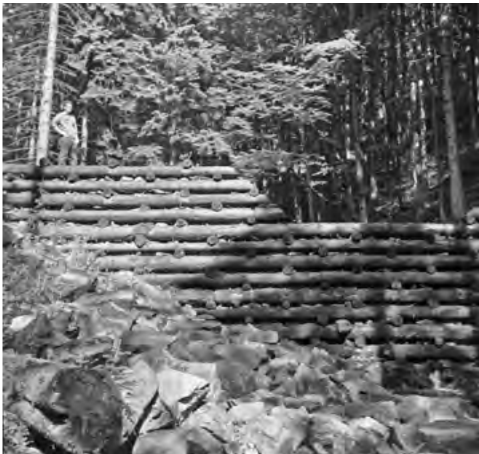
8 Velká srubová přehrážka na levostranném přítoku vodárenské nádrže Šance, Velkém potoku nad klauzou, LZ Ostravice, 1982. Zdroj: autor V. Krečmer (i. č. 107 263).
