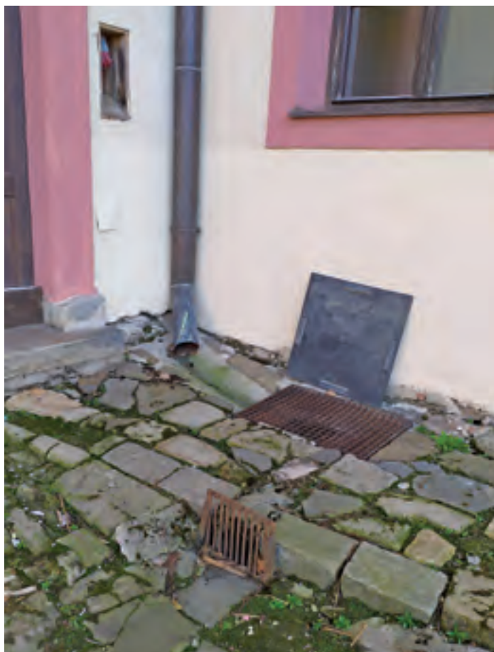
6 Čelní vpusť kanalizační větve E a volné vyústění dešťového svodu. Zdroj: foto Jana Melcrová (2019).
