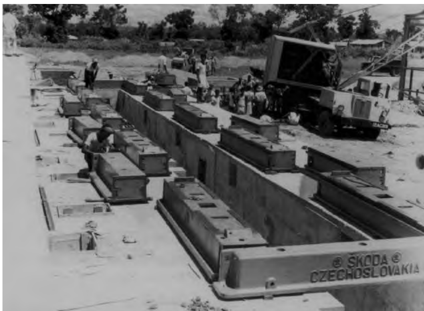
07/ Cukrovar KANTALAI na Cejloně. Základy mlýnice se základovým rámem, snímek z roku 1959, archiv Jaroslava Bartoška
